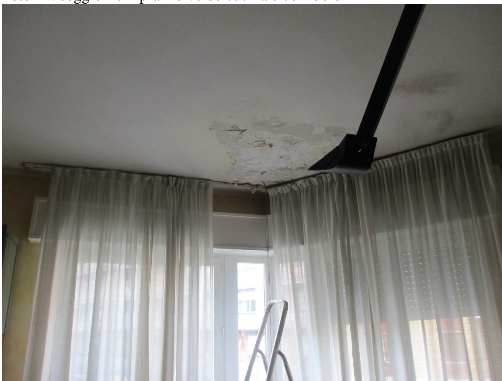
Foto 15: infiltrazione dal tetto
